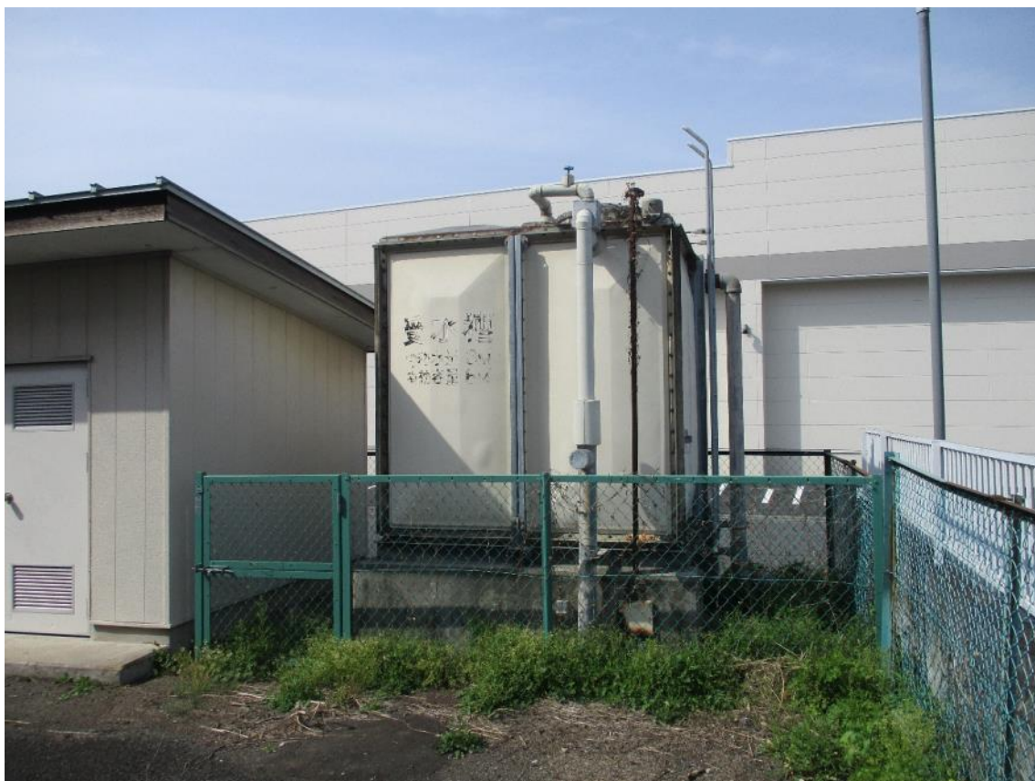
敷地北東角（受水槽）
