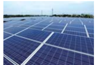
メガソーラー発電所
