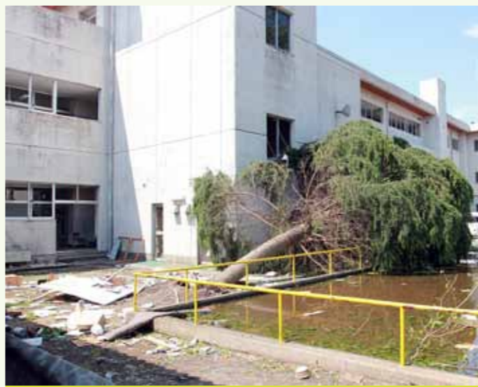
被害を受けた真岡市立西田井小学校
