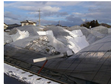
大雪で倒壊したハウス
