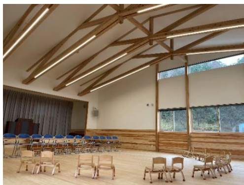
（認定こども園：遊戯室） 下弦材をダブルにして 照明ボックスを兼用
