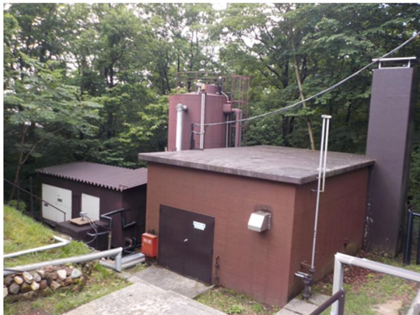
3号ボイラー棟 (左) ヒートポンプ設備、(右) ボイラー設備
