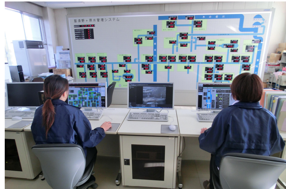
那須野ヶ原総合開発水管理センター操作室
