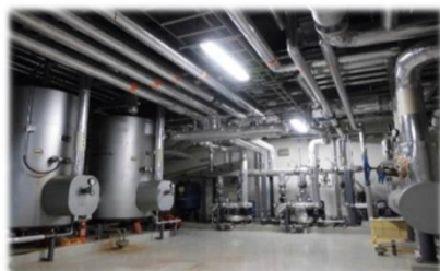
重油等の化石燃料に大きく依存するボイラー
