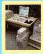
コンテンツプッシュサーバ兼音声応答装置 webのコンテンツを作成し、webサーバへ送信して情報公開を行います。また、光化学スモッグ情報を県民に音声で提供しています。
