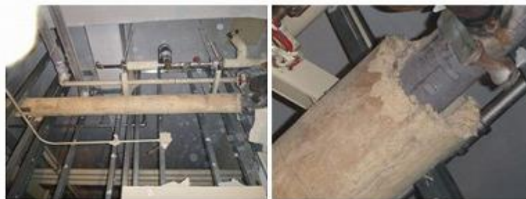
綿テープ類を剥した処すべてに練り保温材が施工されていた。
