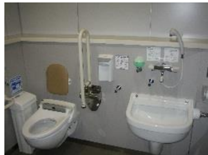
オストメイト対応トイレ (県庁舎本館1階)
