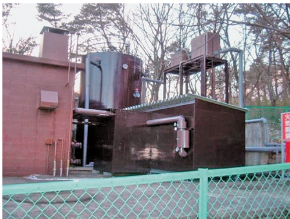
昇温設備（2号棟）
