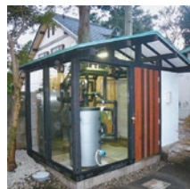
地中熱ヒートポンプ機械室
