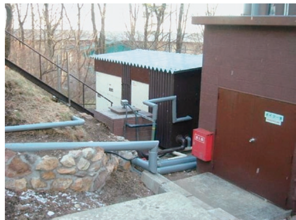
昇温設備（3号棟）
