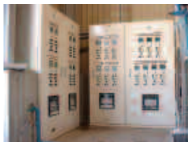
温度制御装置事例
