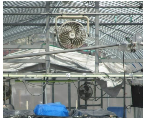
循環扇の設置状況
