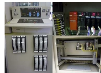
操作盤類機能診断
