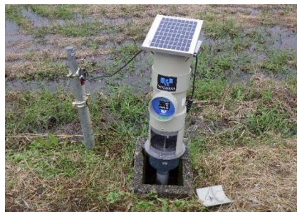
後付けした自動給水栓
