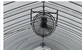
上部の暑い空気を攪拌除去する循環扇
