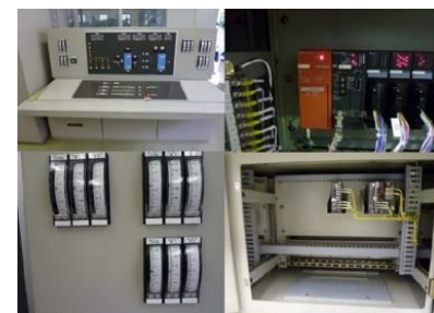
操作盤類機能診断
