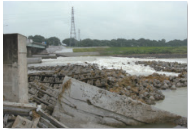
河床低下により倒壊の危険がある堰
