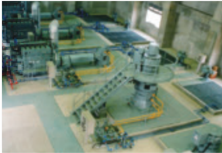
整備された排水機場（界地区）
