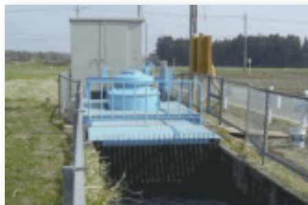
農業用水路を利用した小水力発電施設(那須塩原市)
