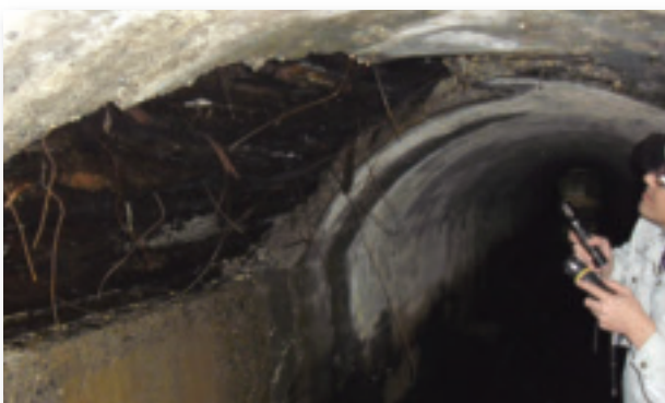
保水対策工事が必要な船生用水のずい道 (塩谷町)
