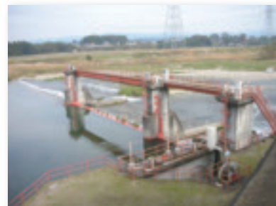
保全対策工事を待つ西の原頭首工（那珂川町）
