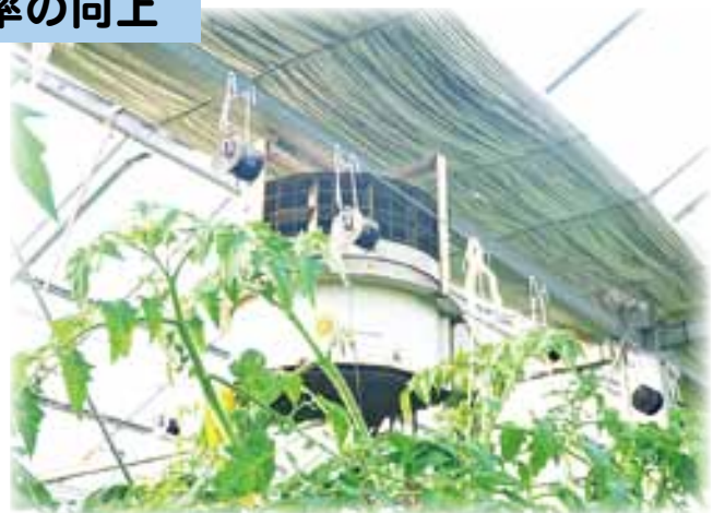
ハウス天井付近に設置された循環扇 (栃木市)
