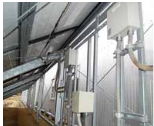
太陽光発電パネル下にある分電盤と電線管
