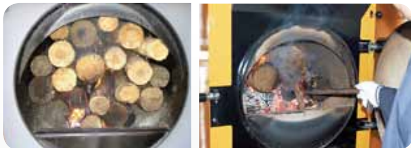
木質ボイラーの燃料の燃焼状況
