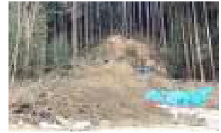
復旧前の漏水事故現場
