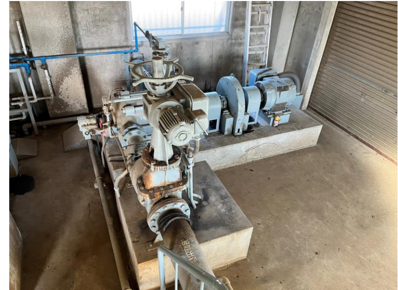
補修予定のポンプ
