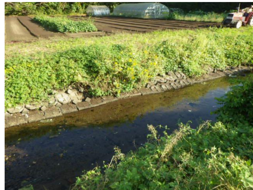
水路の護岸が崩れている様子
