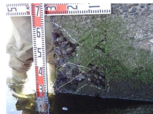
(堰柱腐食状況)
