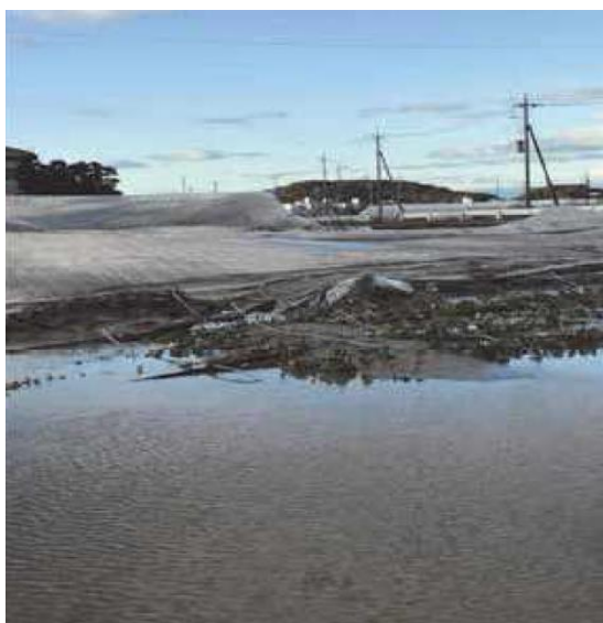
<園芸作物での被害（ハウス倒壊、土砂流入）> 令和元年東日本台風災害における被災状況
