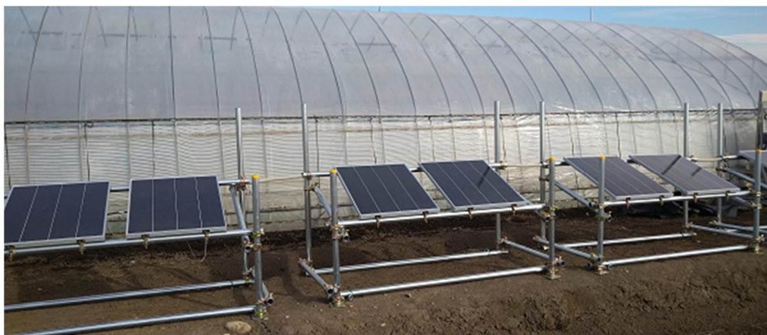
写真 設置した太陽光発電パネル
