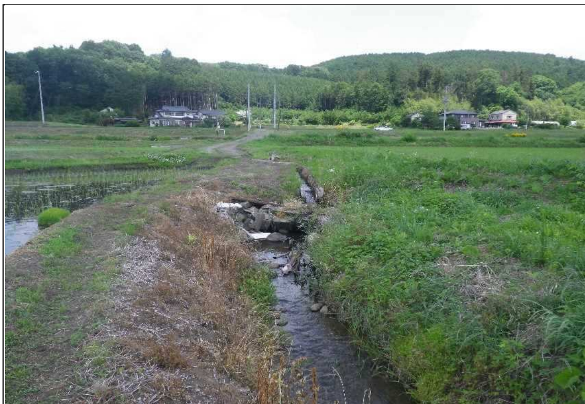
未整備の排水路
