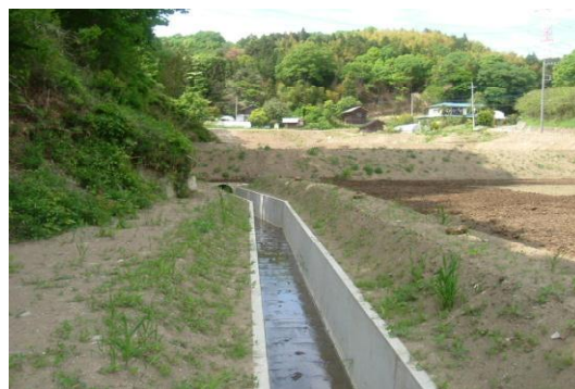
農業用排水施設（整備後）
