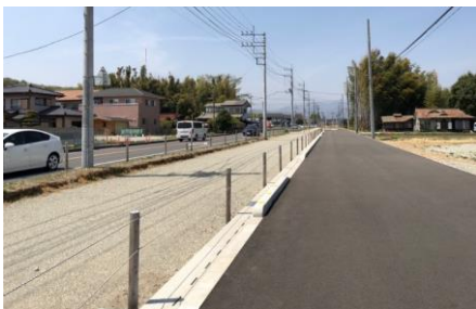
重要物流道路 国道400号 三島・西赤田工区 道路拡幅(那須塩原市)
