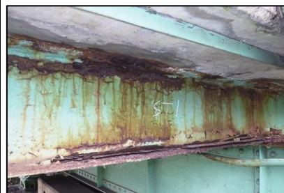
漏水による桁の腐食
