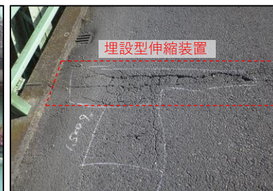
伸縮装置の劣化
