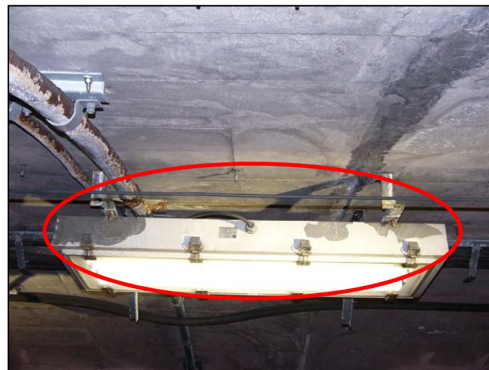
器具の塗装剥離、取付金具の発錆・腐食
