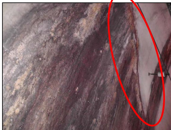
ひび割れ箇所からの漏水、及び遊離石灰
