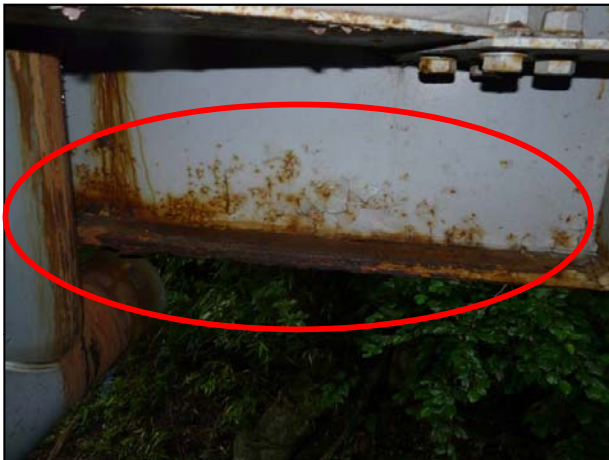
主桁・横桁の損傷
