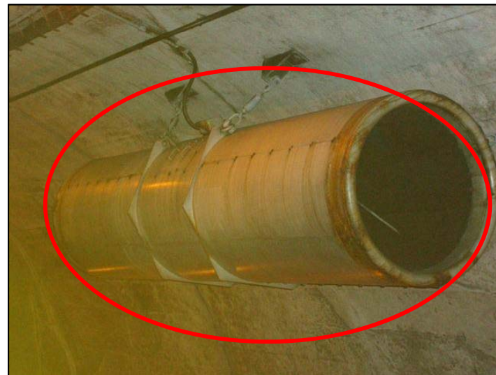
ジェットファン本体の発錆・腐食
