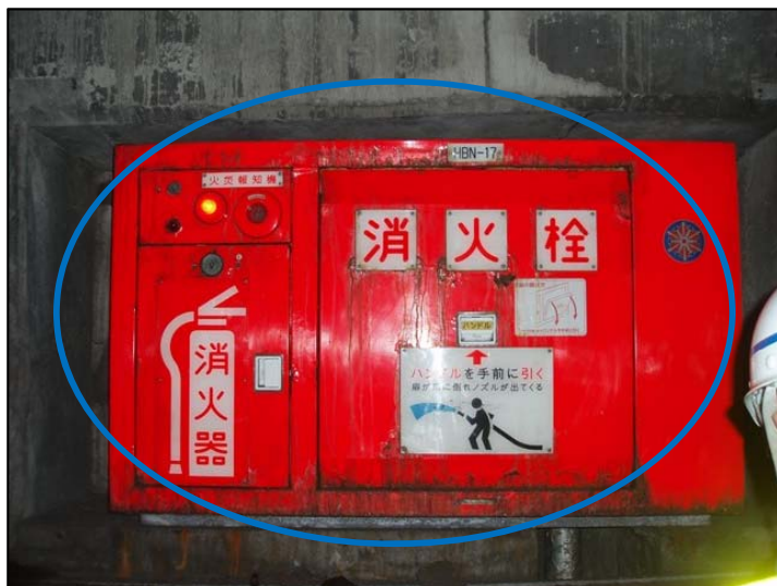
消火栓の発錆・腐食
