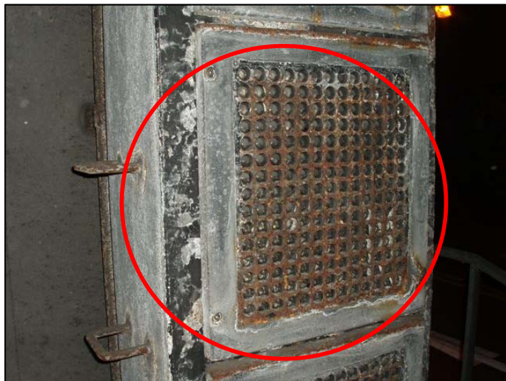
標示板等の発錆・腐食
