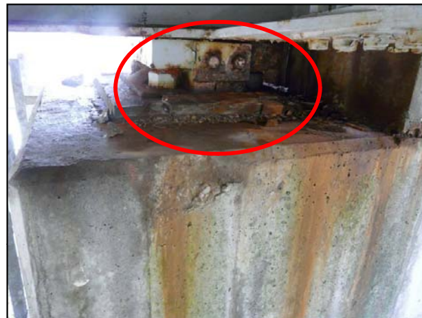
落橋防止・支承の損傷
