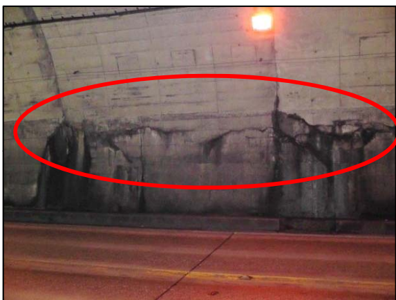
逆巻き工法の縦断方向打ち継目から漏水
