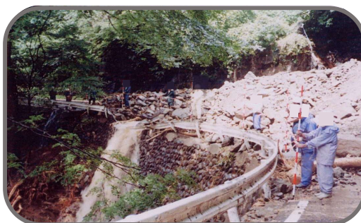
整備前現道部 土砂流出状況
