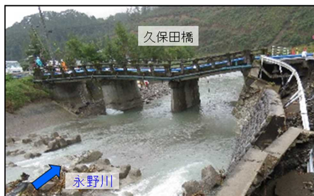
図 2-1-8：令和元年東日本台風による被災（一般県道上永野下永野線：久保田橋）
