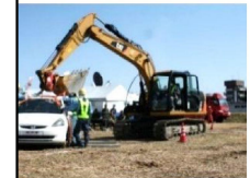
クレーンを用いた車両移動作業訓練の様子 「道路啓開手順書(案)」掲載
