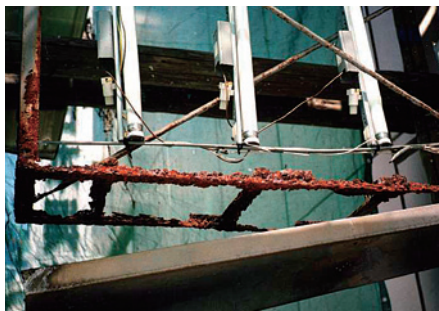
袖看板の底部脱落
