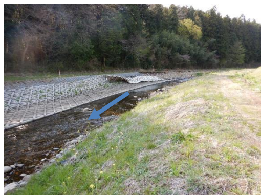
《被災状況写真》
