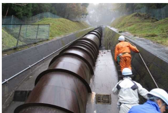
足尾発電所水圧鉄管
