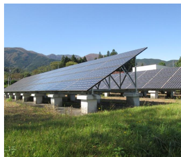
太陽光発電設備(北那須水道事務所)
