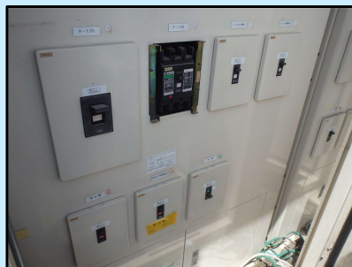
①受変電設備 (内部)
