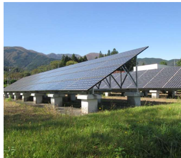
太陽光発電設備(北那須水道事務所)
