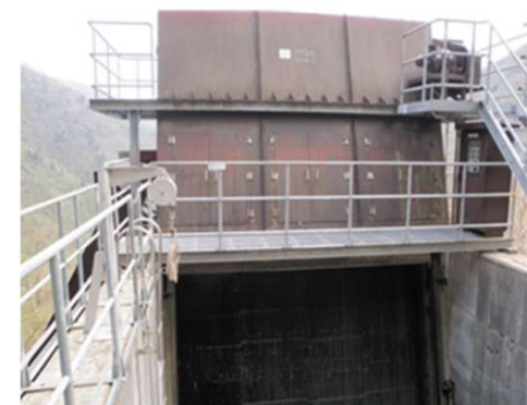
除じん機 (除じん機等更新工事)
