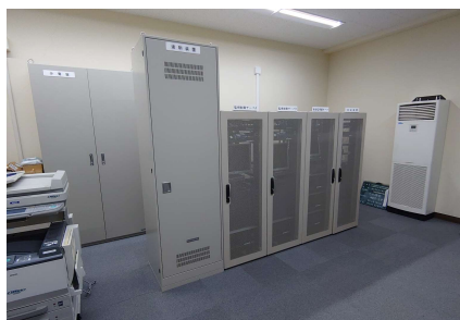
集中監視制御サーバー(今市発電管理事務所)
