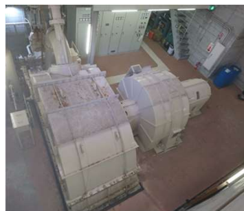
発電機(深山発電所)
