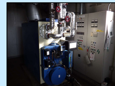
④ボイラー
