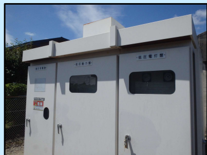
①受変電設備
