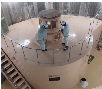
発電機(板室発電所)
