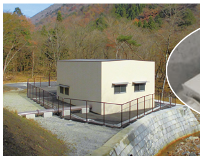
▲小百川発電所と水車・発電機 小百川発電所は、令和3(2021)年1月に運転を開始した発電所です。既設の砂防堰堤(副堰堤)から取水し、約2km下流の発電所との落差を利用して発電しています。
