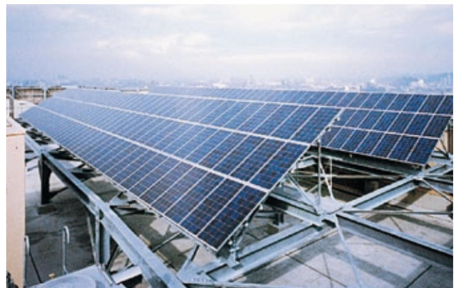
▲地球温暖化対策の一環として設置した太陽光発電設備 (太陽光発電設備：多結晶シリコン電池使用) 出力20kVA
