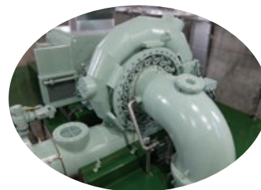
▲五十里発電所と水車・発電機 五十里ダムからの河川維持流量を利用し、令和2(2020)年5月に運転を開始した発電所です。
