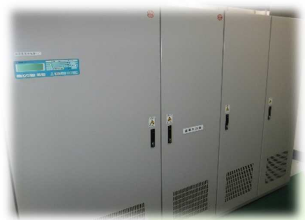
無停電電源装置
