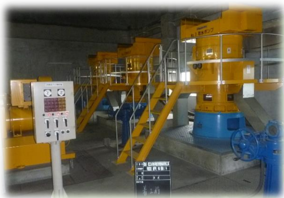
取水ポンプ(更新前)
