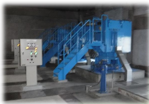
取水ポンプ(更新後)
