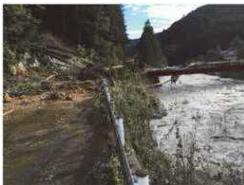
【鹿沼市「山の神地区」被災箇所】
