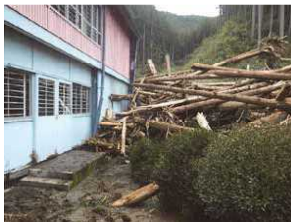
被災状況（鹿沼市下粕尾 学校沢）
