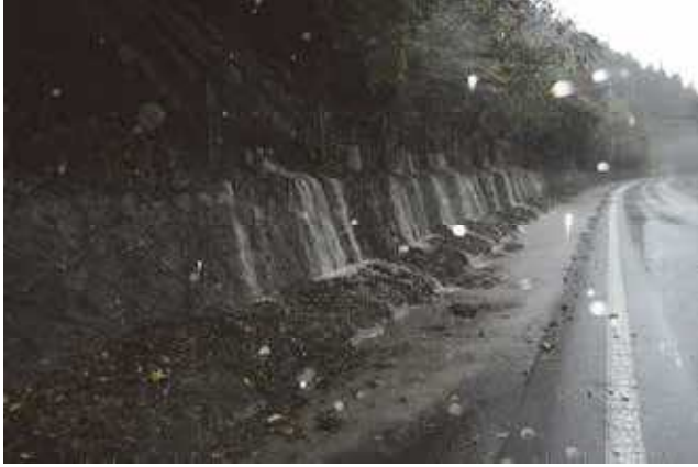
日光宇都宮道路 大雨による路面状況
