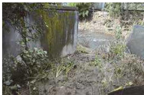
【流出箇所（被災後）】
