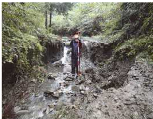
森林作業道の被災状況（那須町内）
