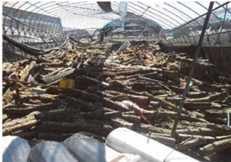
栽培きこの施設の被災状況（矢板市）
