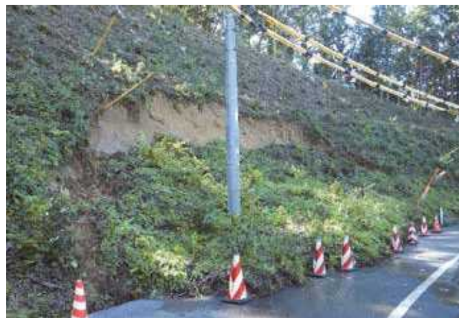
宇都宮 IC～矢板 IC 間 上り線 側道部の土砂崩落状況
