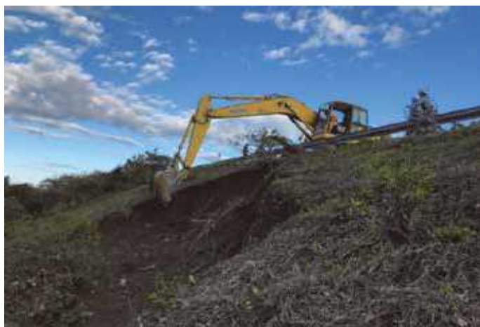
栃木都賀 JCT～鹿沼 IC 間 下り線 側盛土の土砂崩落状況
