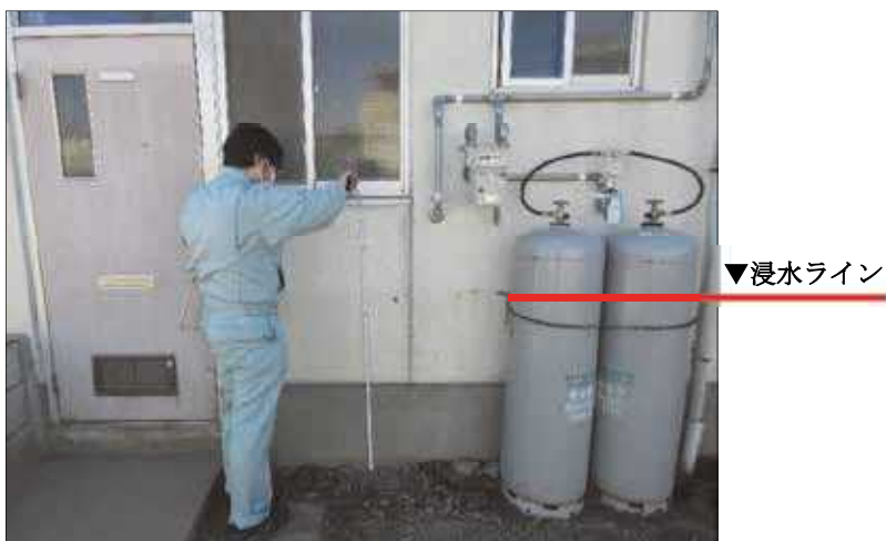
床上浸水被害 (大橋市営住宅)
