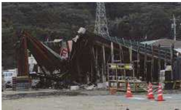
(栃木市内の店舗損壊被害)
