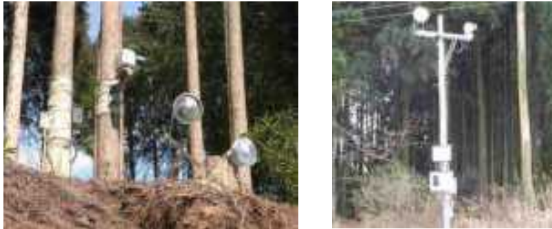
図 7.4 霧島山の噴火対応で緊急設置した監視カメラ
