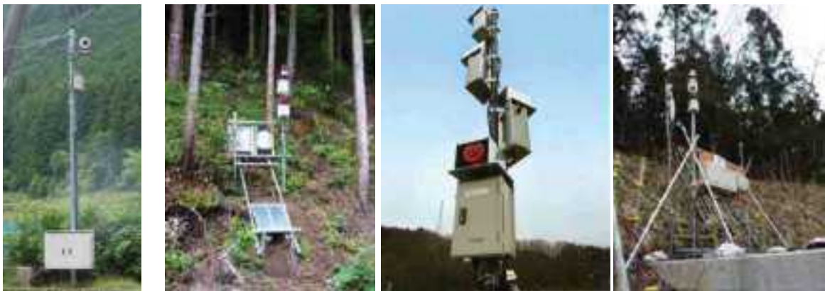
図 7.7 警報局設置事例
