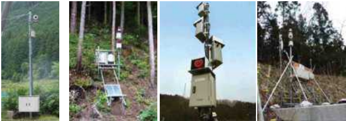
図 7.7 警報局設置事例
