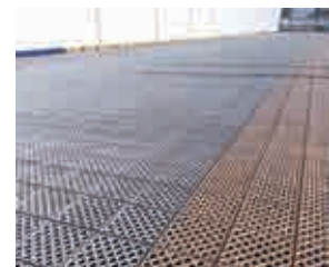
プールサイドの破損・修理・苔の除去
