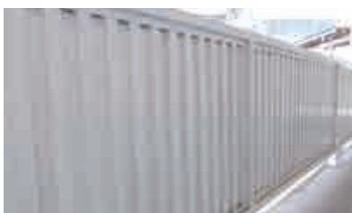
通路の破損・サビ
