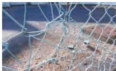
フェンスの破損・修理
