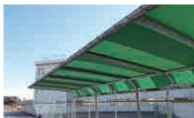
日よけの破損・修理
